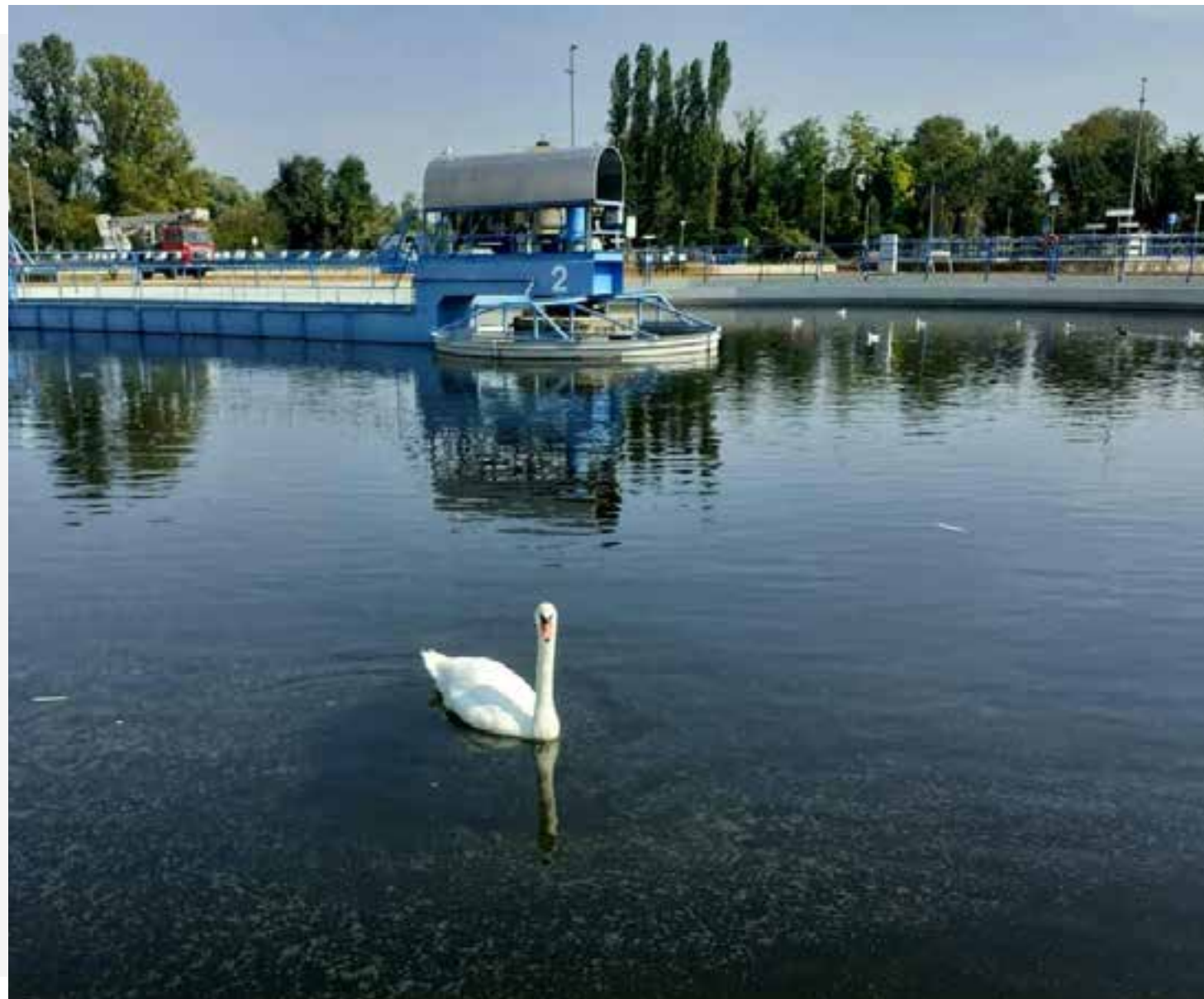
Acque Veronesi Depuratore di Verona (VR), vasche di sedimentazione secondaria
