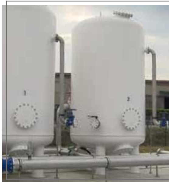
Acque del Chiampo Filtrazione anti PFAS a Montorso Vicentino (VI)
