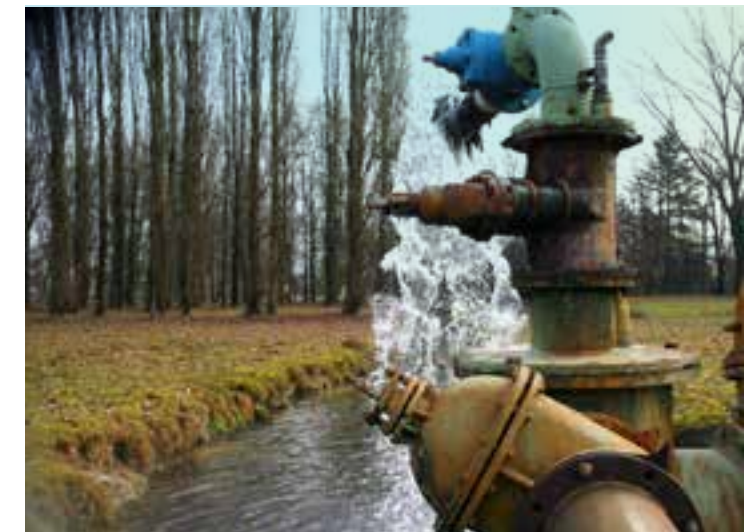
Veritas Area campo pozzi a Scorzè (VE)
